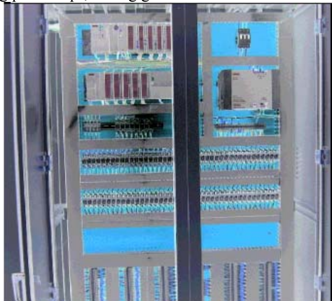
Hình 3: Mô hình của tủ điện có lắp đặt PLC.
